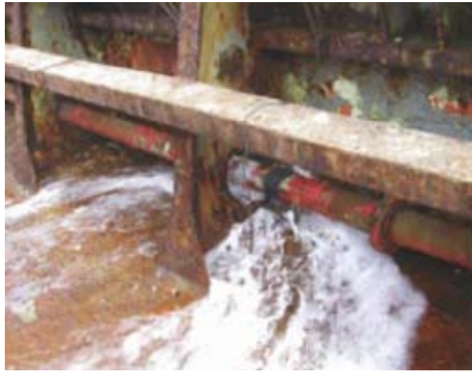
東京MoU検査官により発見された更なる欠陥: 腐食し穴のあった消火用のパイプ
