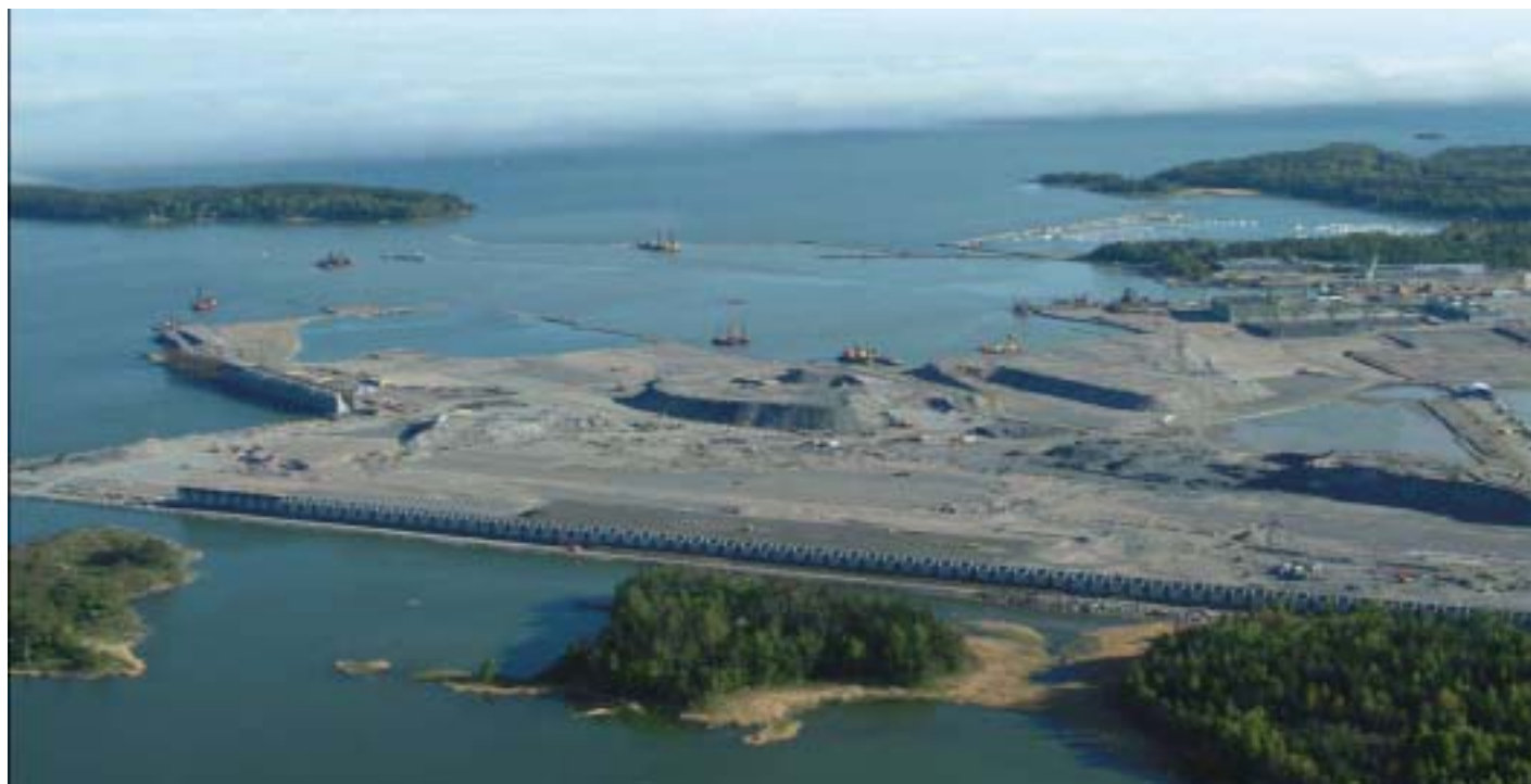
ヘルシンキの新ヴァーサリ港には巨大な防音壁が設置されている
