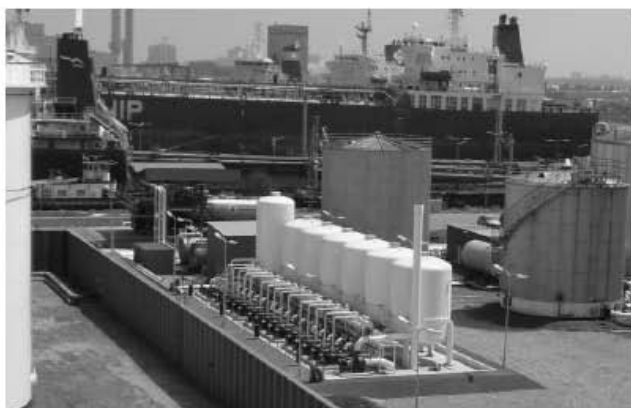
VOC の除去装置(アントワープ港)
