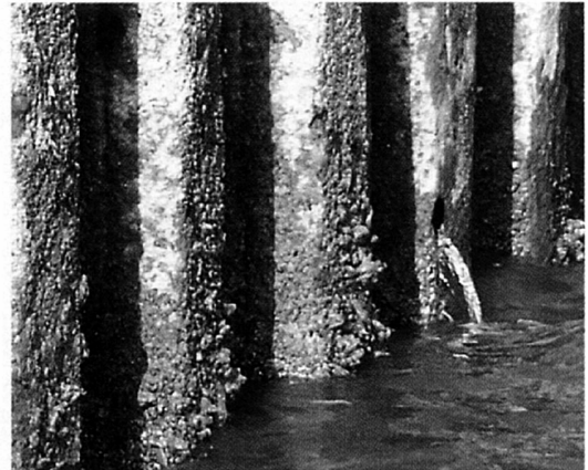
図 3 干潮時鋼矢板のさびの穴からの漏水
