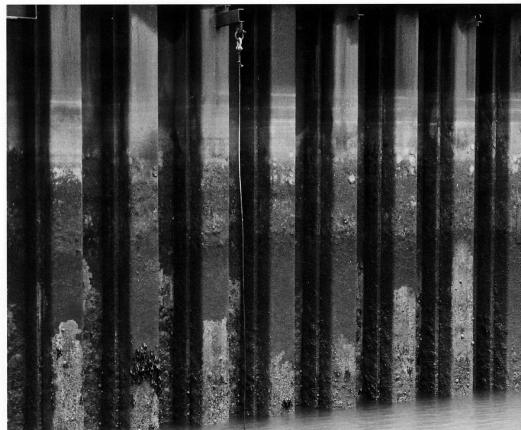
図 1 鋼矢板の腐食状況
